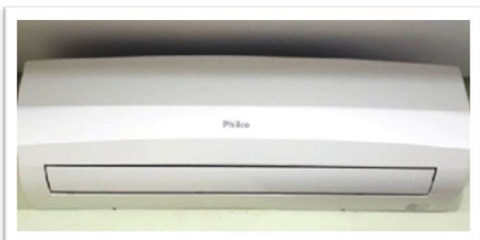
Figura 18: Aparelhos de ar Condicionado, instalados nas salas do Centro Cirúrgico e na Unidade de Terapia Intensiva (UTI) Geral
